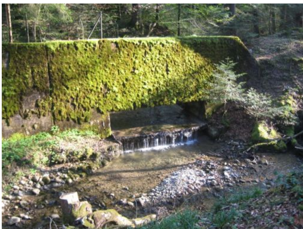
Bachdurchlass in der Tankmauer Büttenenloch - auch wirksam als Hochwasserrückhalte- und -dosiersystem
