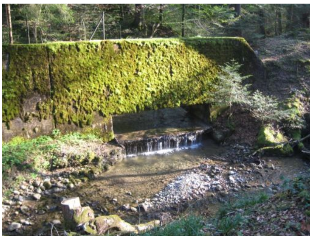
Bachdurchlass in der Tankmauer Büttenenloch - auch wirksam als Hochwasserrückhalte- und -dosiersystem
